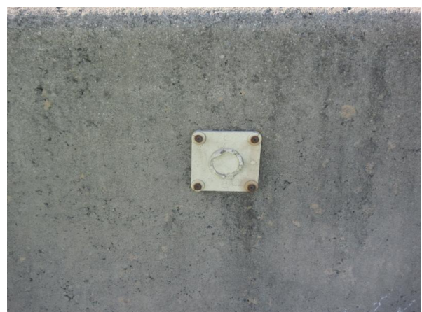
텔레네이트 파손 S3
