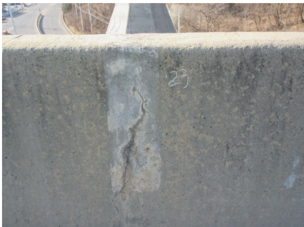
방호벽 보수부 재균열(0.3mm미만) S2
