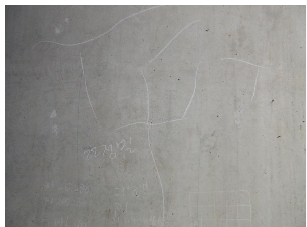
교각 망상균열 P1
